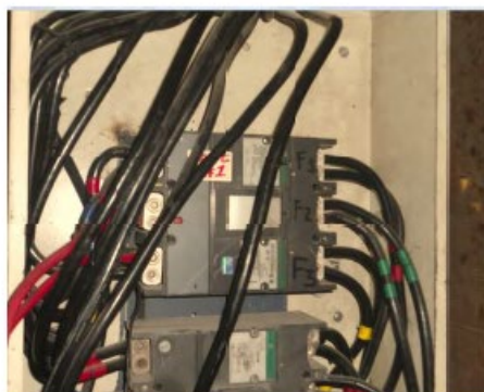
Imagen III-1: Panel secundario breaker principal 400 amperios, foto estándar.
