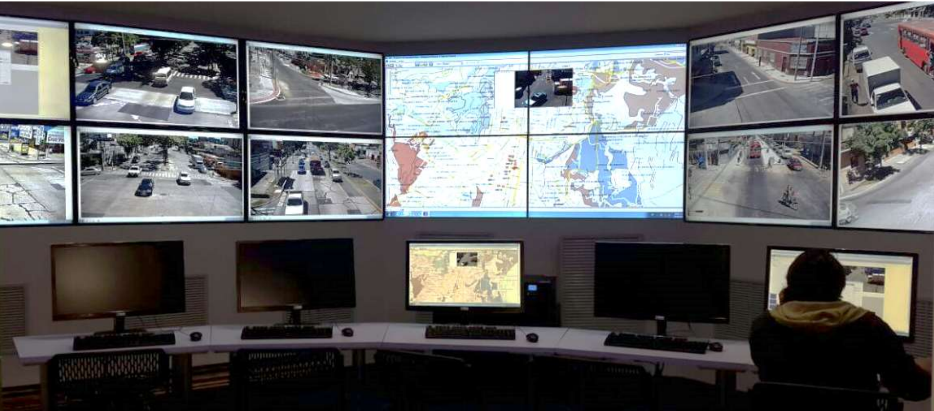
Centro de Control, Comando y Comunicaciones (C4) en EMTRA Municipalidad de Guatemala
