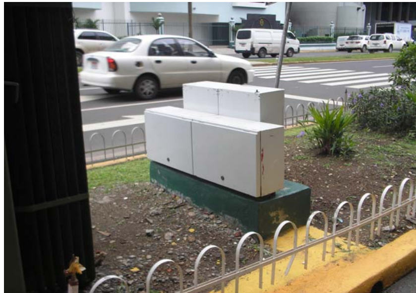
Instalación de equipos del Sistema de Medición Comercial (SMEC) en la entrada principal del edificio sede, correspondientes al proyecto Gran Cliente Eléctrico
