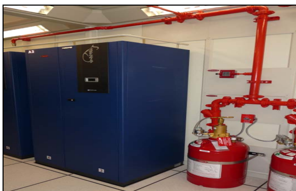
Sistema de Detección y Extinción de Incidentes del Centro de Datos Institucional (Sala Cofre) 04/12/2012
