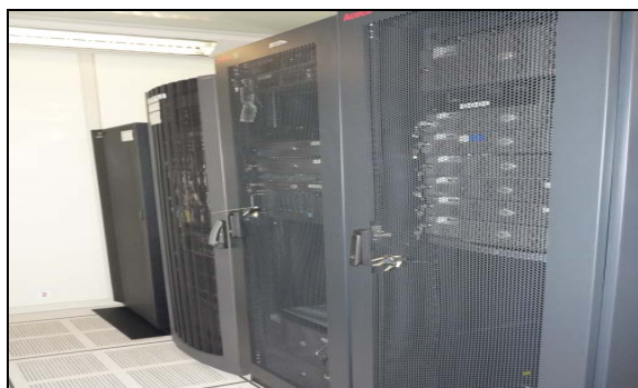
Nuevos Racks del Centro de Datos Institucional (Sala Cofre) 04/12/2012
