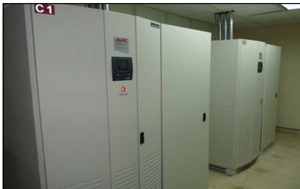
Sistema de UPS del Centro de Datos Institucional (Sala Cofre) 04/12/2012
