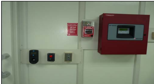
Sistema de Control de acceso del Centro de Datos Institucional (Sala Cofre) 04/12/2012
