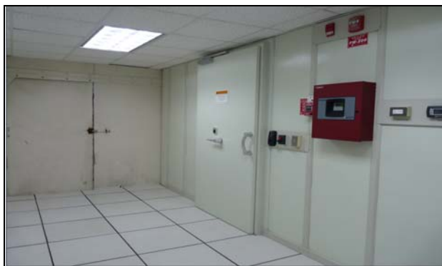
Acceso al nuevo Centro de Datos Institucional (Sala Cofre) 04/12/2012
