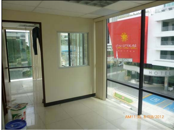
Adecuación de local alquilado en el Edificio Ralphco para oficinas del Instituto Nacional de Estadística y Censo
