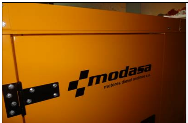
Planta Eléctrica del Centro de Datos Institucional (Sala Cofre) 04/12/2012
